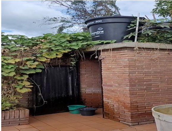
Fuente: Registro fotográfico tomado en la ORIP – fuga del tanque de agua potable de la Oficina.
